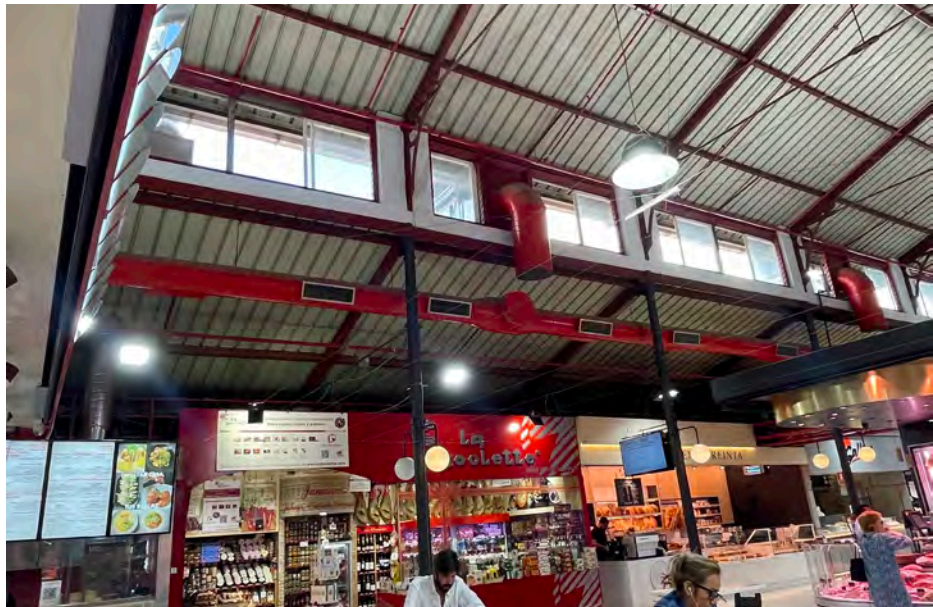
5.20. Imagen luminarias actuales.
