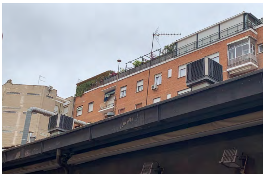
5.6. Sistema evaporativo en el Mercado de la Paz situado en la cubierta.
